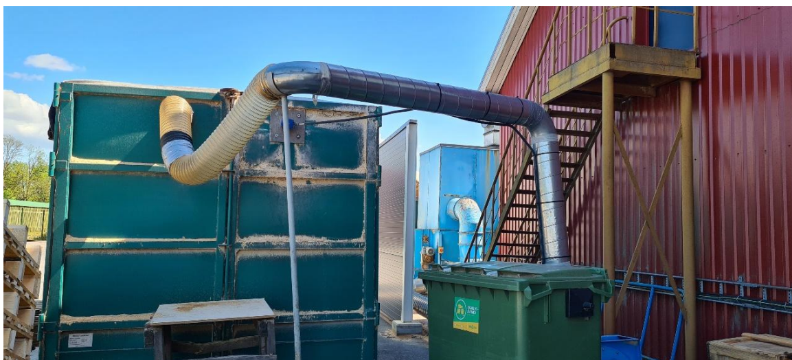
Foto 2. Soojuse tee 18 aspiratsiooniseade, mille tööaeg 8-16, mõõtmispunkt nr. 7
