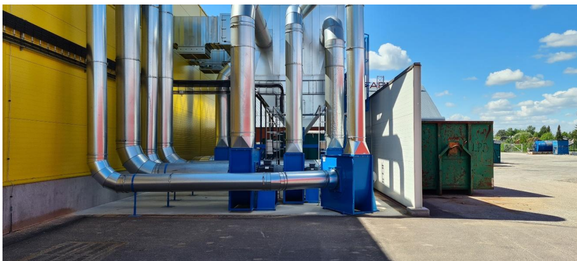
Foto 6. Soojuse tee 18 aspiratsiooniseadme mootorid, mõõtmispunktid nr. 14-15
